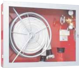
Boca de incendio equipada (BIE)
